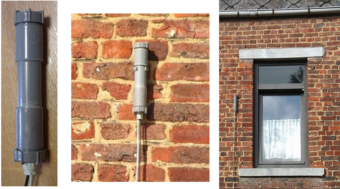
Figure 3: l'antenne terminée dans son « boîtier » étanche sur la façade arrière du QRA
